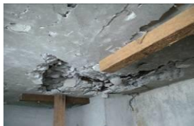
天花板鋼筋外露
