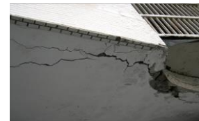
外牆鋼筋外露
