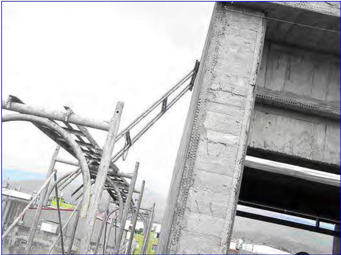
照片 10：施工架上違規設置梯子當上下設備。
