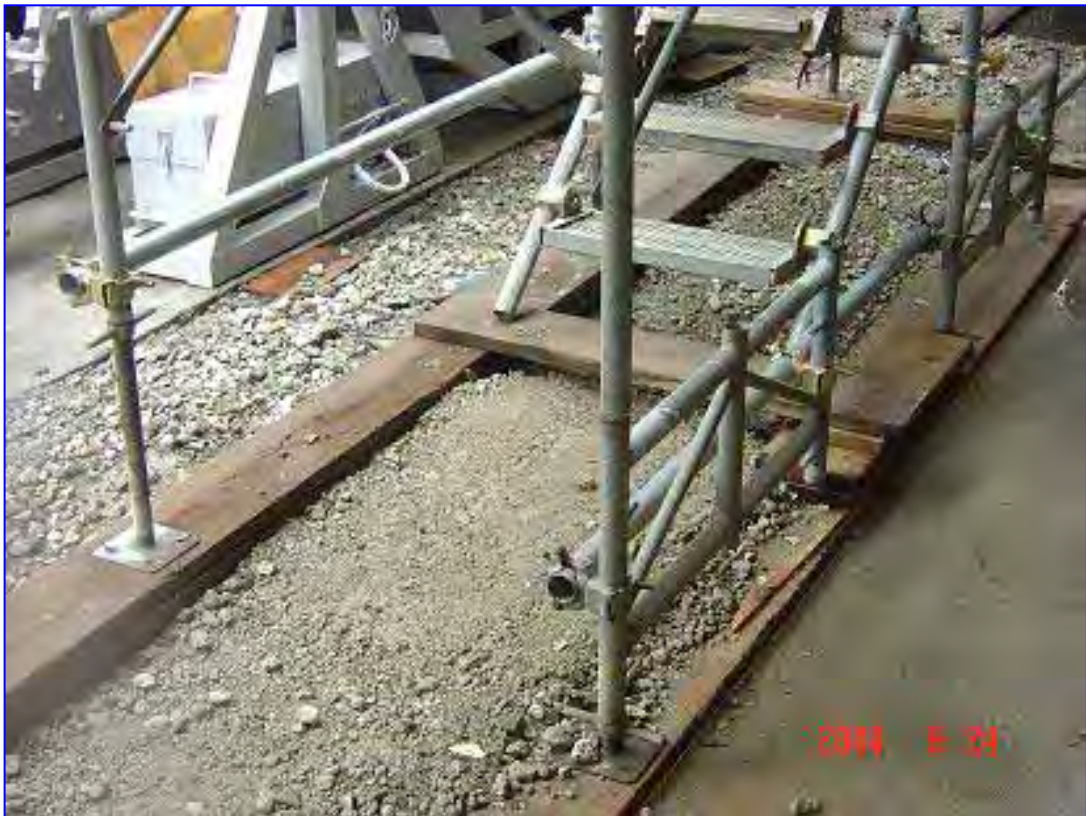
照片 9：施工架底部之立架設可調型基腳座板，基礎地面應平整、夯實緊密、襯以適當材質之墊材，以避免產生不均勻沉陷。
