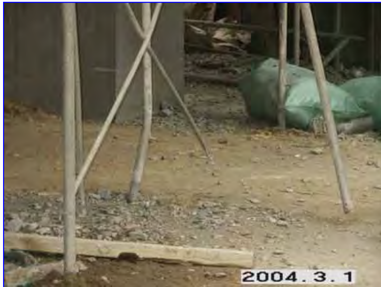
照片 6：施工架之立架腳柱變形，影響施工架之強度。
