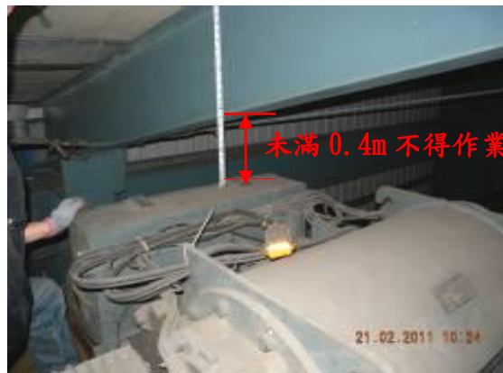
圖 4 吊運車在桁架終端位置與建築物間隔未滿 0.4 公尺， 應於維修時將吊運車移至桁架中間，使其間隔達 0.4 公尺以上，並設置連鎖裝置
