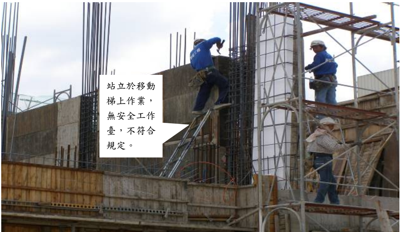
6. 站立移動梯、合梯頂上作業，無安全之工作臺，不符合規定之照片。
